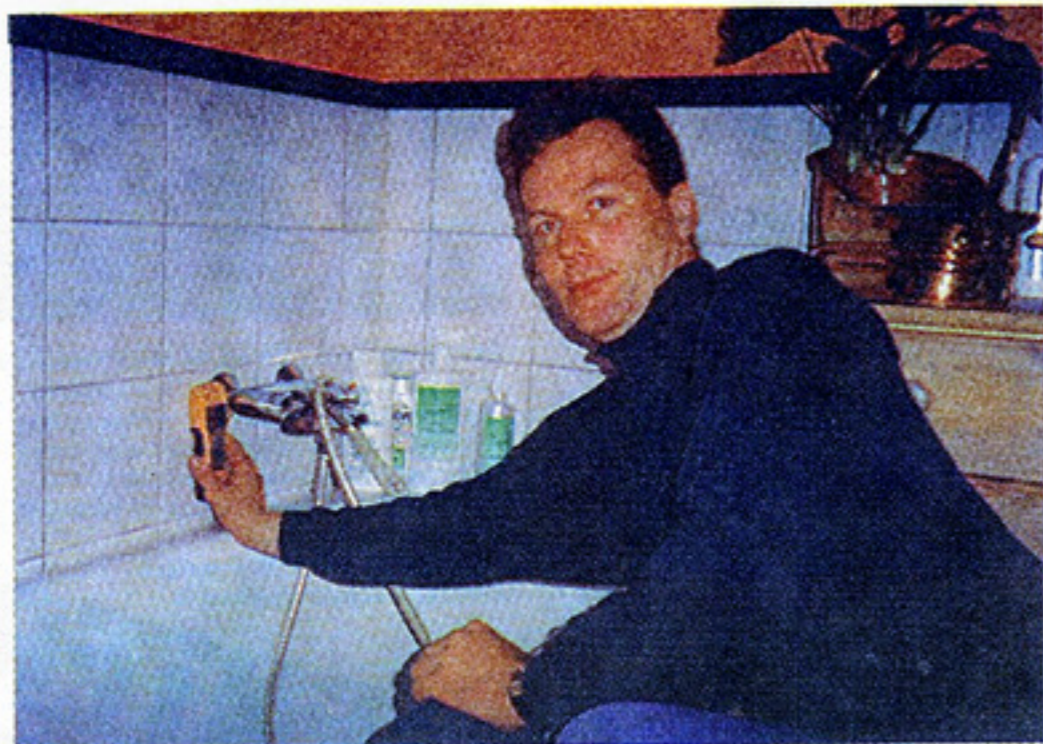
Arild Grundetjern måler fuktigheten på badet.
